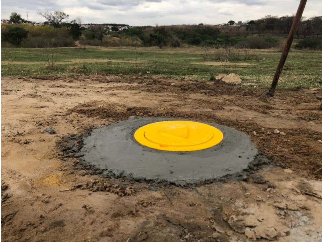
Figura III: Poço de Monitorização PM-01 Novo
