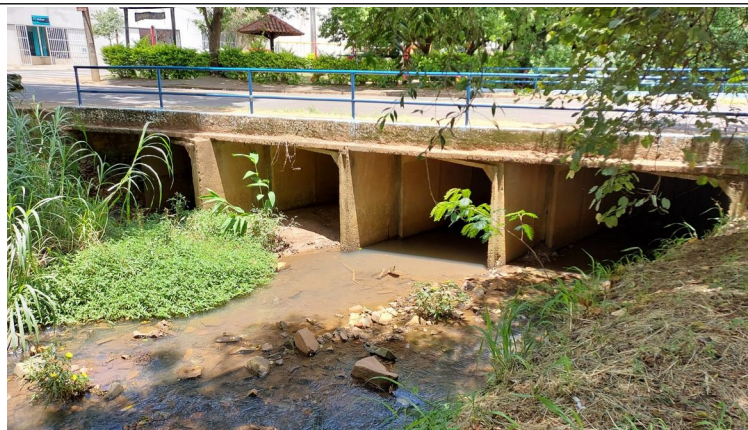
Foto 2: Vista de jusante da ponte da R. Oscar de Souza Geribelo, sobre o córrego Santa Maria do Leme. Grande acúmulo de sedimentos no leito, com obstrução total de duas linhas de aduelas.
