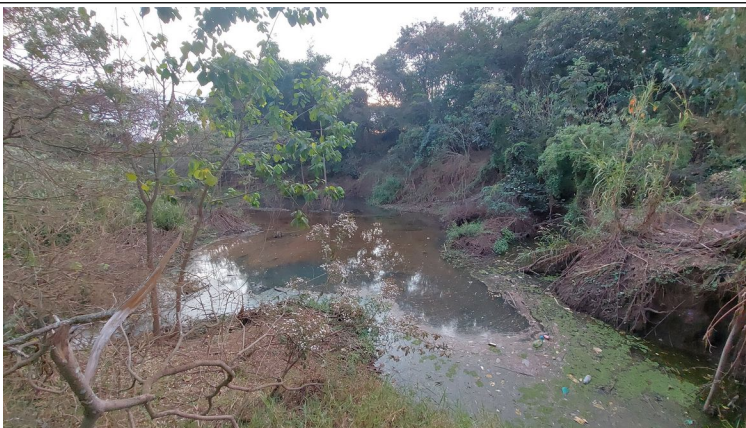
Foto 8: Vista da chegada do Córrego Cambuí (esq.) no córrego Santa Maria do Leme. Verifica-se acentuados processos erosivos, comprometendo a APP. Há risco de comprometimento dos interceptores do sistema de esgoto sanitário existente junto às margens. Grande acúmulo de sedimentos e formação de bancos no leito.
