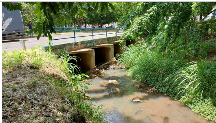
Foto 3: Vista de montante da ponte da R. Oscar de Souza Geribelo, sobre o córrego Santa Maria do Leme. Grande acúmulo de sedimentos no leito e margem esquerda, com obstrução total de duas linhas de aduelas (esq.) e restrição do fluxo nas demais.
