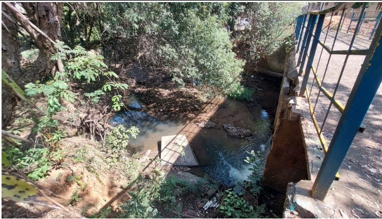
Foto 7: Vista de jusante da passarela da R. Brás Cubas, córrego Santa Maria do Leme. Grande quantidade de sedimentos e ocorrência de severo processo erosivo nas margens, com comprometimento da estrutura da passarela (em andamento processo para obra de recuperação do dispositivo)
