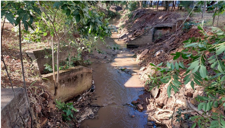
Foto 6: Vista de jusante a partir da ponte da R. João Ramalho, córrego Santa Maria do Leme. Acentuado acúmulo de resíduos no leito e processos erosivos em ambas as margens, comprometendo a infraestrutura dos pontos de lançamento de microdrenagem.
