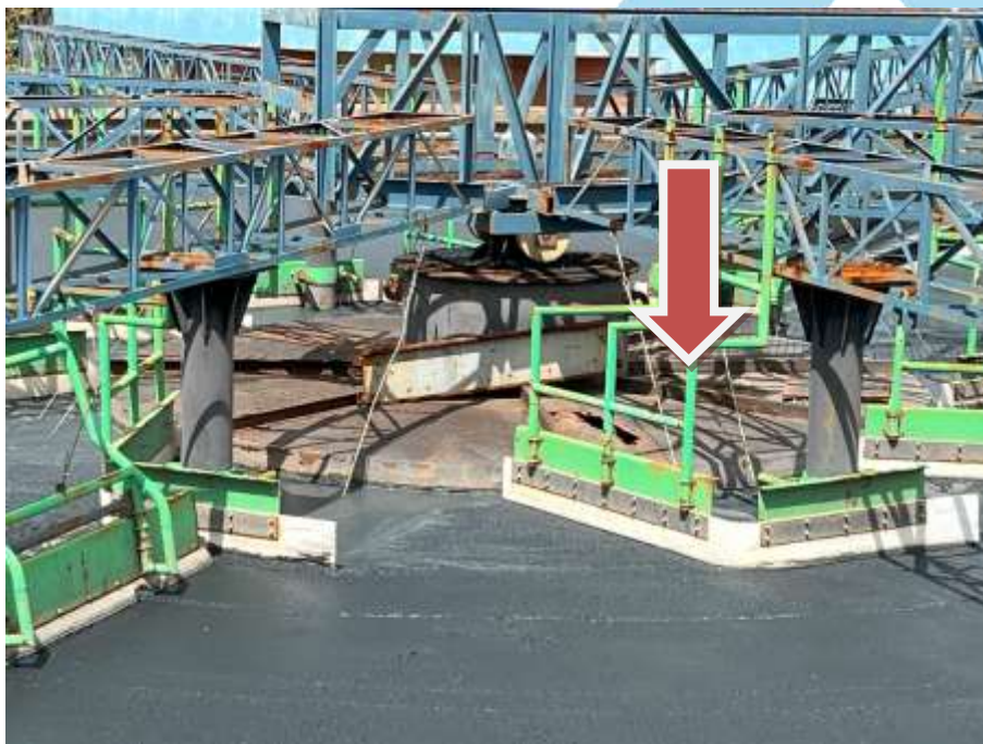
Figura 1: pontos de oxidação e aberturas ocasionadas pela ferrugem na parte superior da coluna central do flotador.
