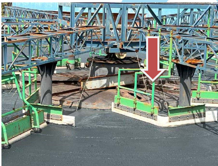
Figura 1: pontos de oxidação e aberturas ocasionadas pela ferrugem na parte superior da coluna central do flotador.
