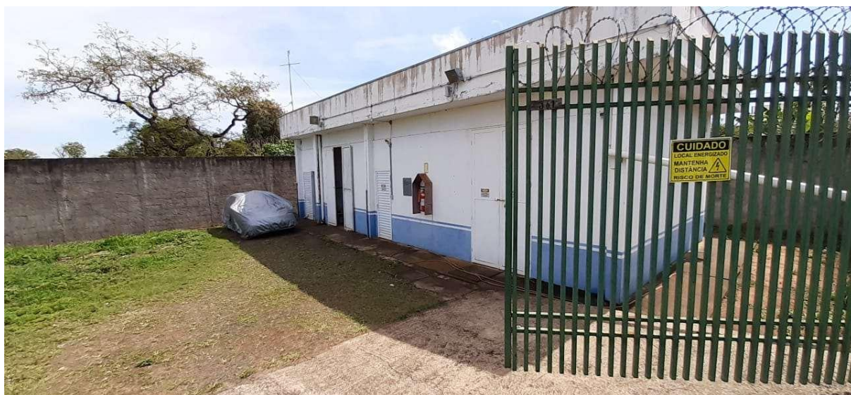
Imagem 3: Cabine de quadros e sala do operador.
